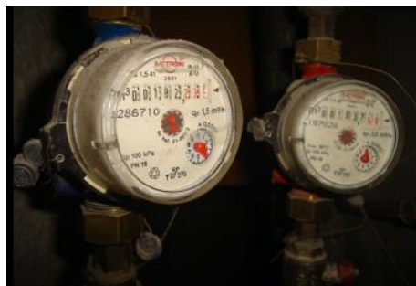
Ein mechanischer Wasserzähler
